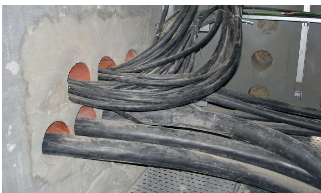
Intérieur du bâtiment Plusieurs câbles aux des diamètres différents sont introduits dans le bâtiment.
